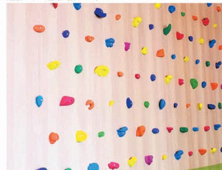
C:コンパネ+クロス(内装施工仕上げ) 内装工事でホールドを取付けて頂く方法です。お好みのデザインに仕上げることが出来ます。
